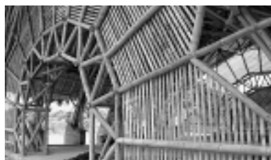
Diese Bambuskirche in Ecuador war vom Verfall bedroht
