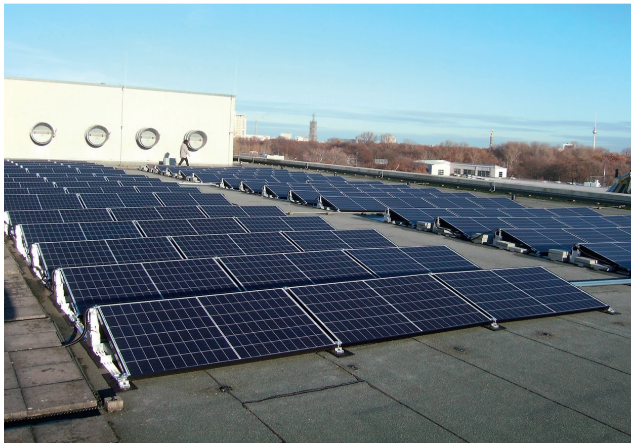
107 Solarmodule versorgen seit Ende März die Uni-Bibliothek mit Strom
