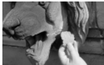
Viele Steinbrocken saßen locker an der Fassade. Diese Gefahr muss beseitigt werden
