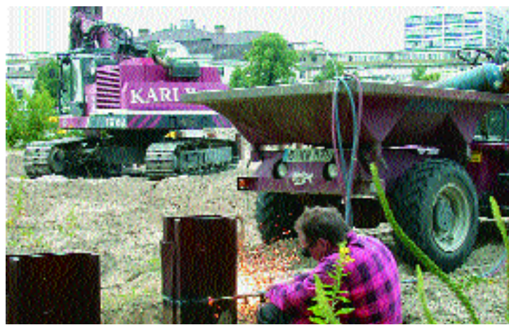
Bagger und Raupen fahren hin und her, Leitungen werden verlegt: Neues Leben auf dem Bauplatz
