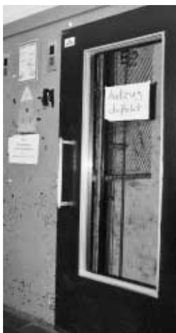
Reparaturbedürftig: nicht nur die Aufzüge
