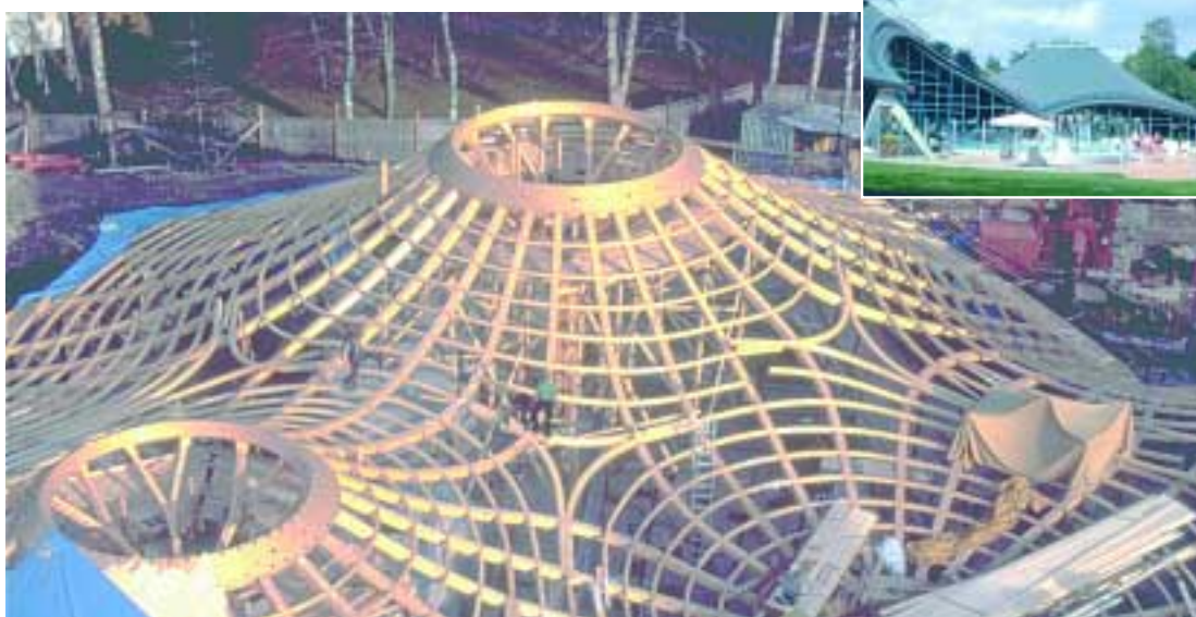
Ein Beispiel für Anmut und Können im Holzbau: Solebad in Bad Dürrenheim im Bau und nach der Fertigstellung (o. r.)
