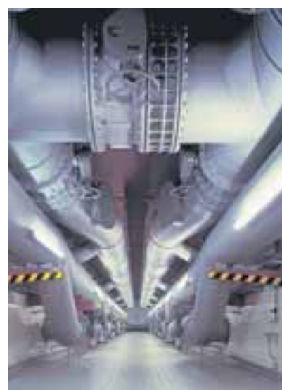
Innenansicht des Wasserwerks Berlin-Spandau
